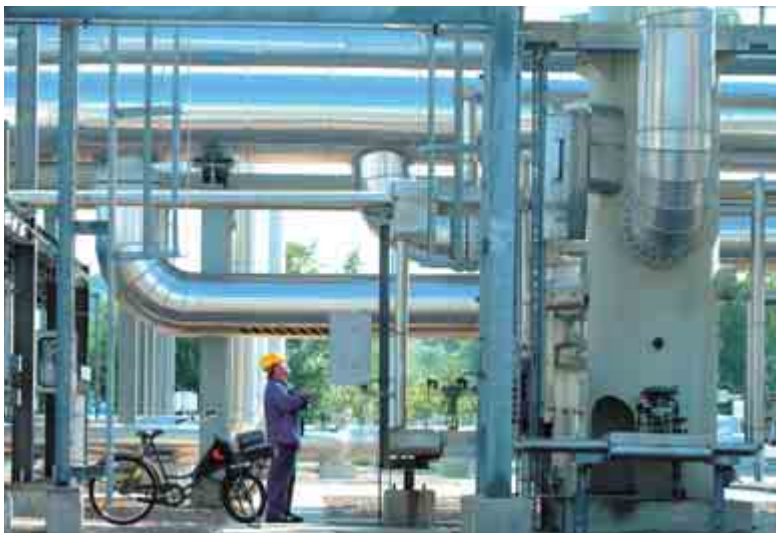
Die WTZ-Experten aus Deutschland und Russland arbeiten im Erdgasspeicher in Rehden zusammen
