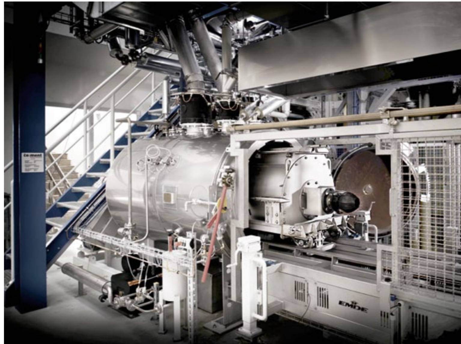
Hier wird der innovative Zement hergestellt: die Celitement-Pilotanlage auf dem Campus Nord des KIT / Foto: Markus Breig
