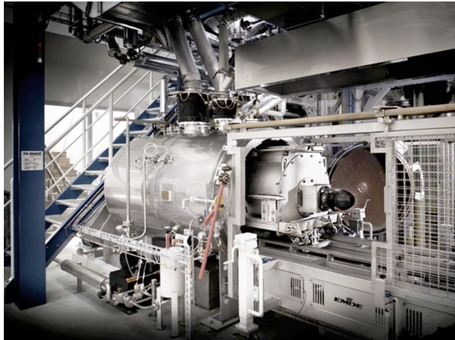
Hier wird der innovative Zement hergestellt: die Celitement-Pilotanlage auf dem Campus Nord des KIT / Foto: Markus Breig
